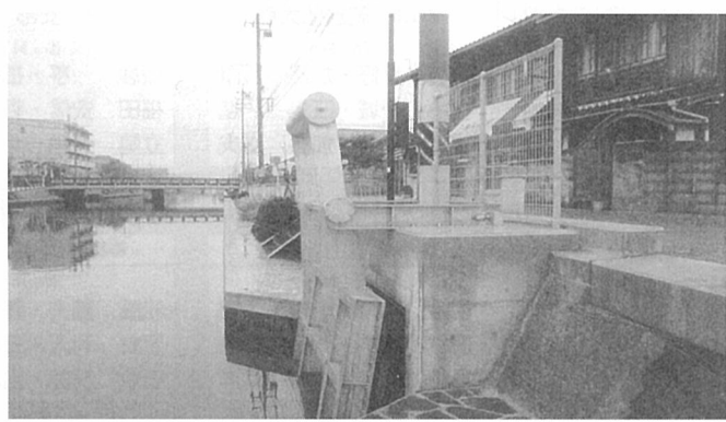
逆流防止施設
