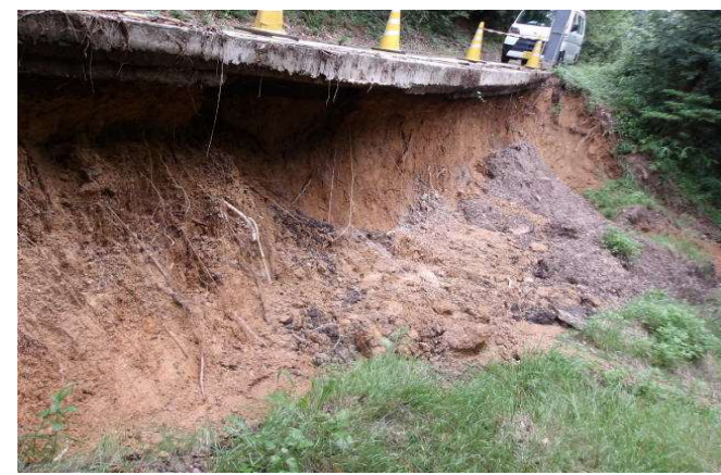
えんぎ 円木中谷線法面崩落（大垣町）
