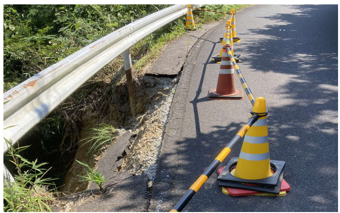
しんやま 林道真山線路肩崩落（法吉町）
