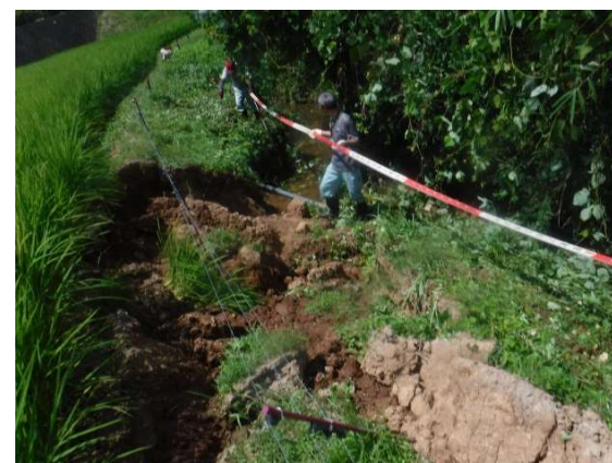
奥谷川護岸崩落（八雲町平原）
