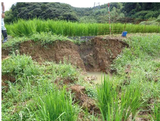
水田法面崩落（鹿島町北講武）
