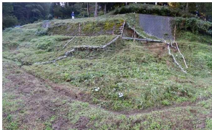
水路法面崩落 (玉湯町大谷)
