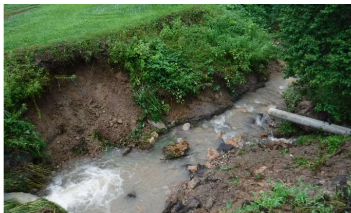
大谷排水路護岸崩落 (東忌部町)
