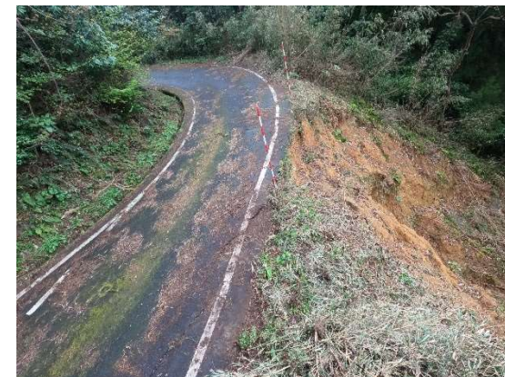
林道里路線法面崩落 (島根町野波)
