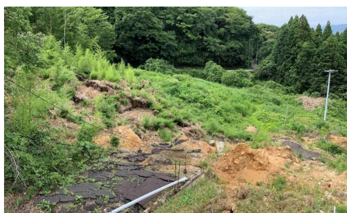
【令和2年】堂廻忌部開拓線地すべり (西忌部町)
