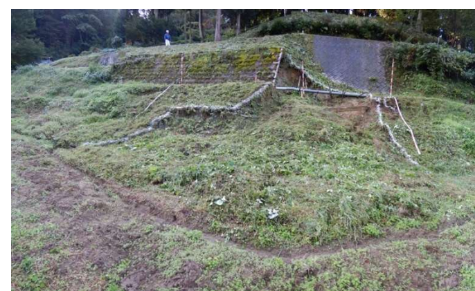
【令和3年】水路法面崩落 (玉湯町大谷)
