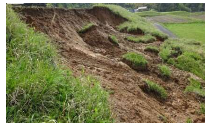
【令和4年】水田法面崩落 (宍道町上来待)
